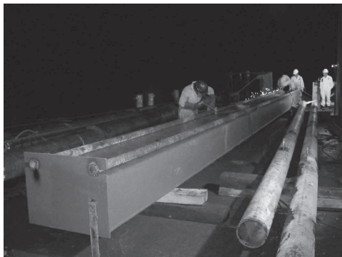
底托梁梁面增加的喷水管
