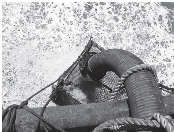
抽泥出泥口及过滤网
